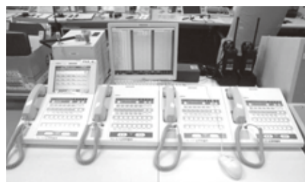
消防・救急デジタル無線統制台
