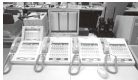
消防・救急デジタル無線統制台
