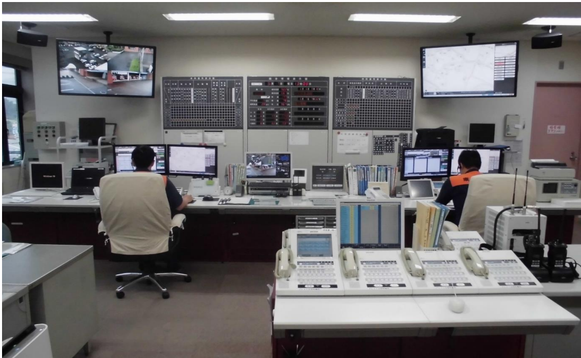
高機能消防指令センター
